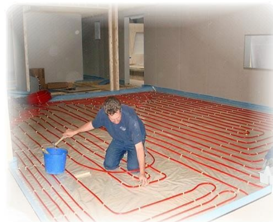
Vloerverwarming bron: Wellink installatie BV
