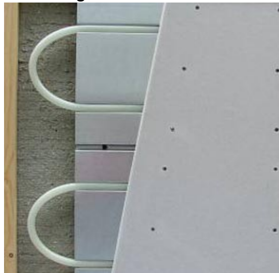
Wandverwarming bron: atrium nijmegen
